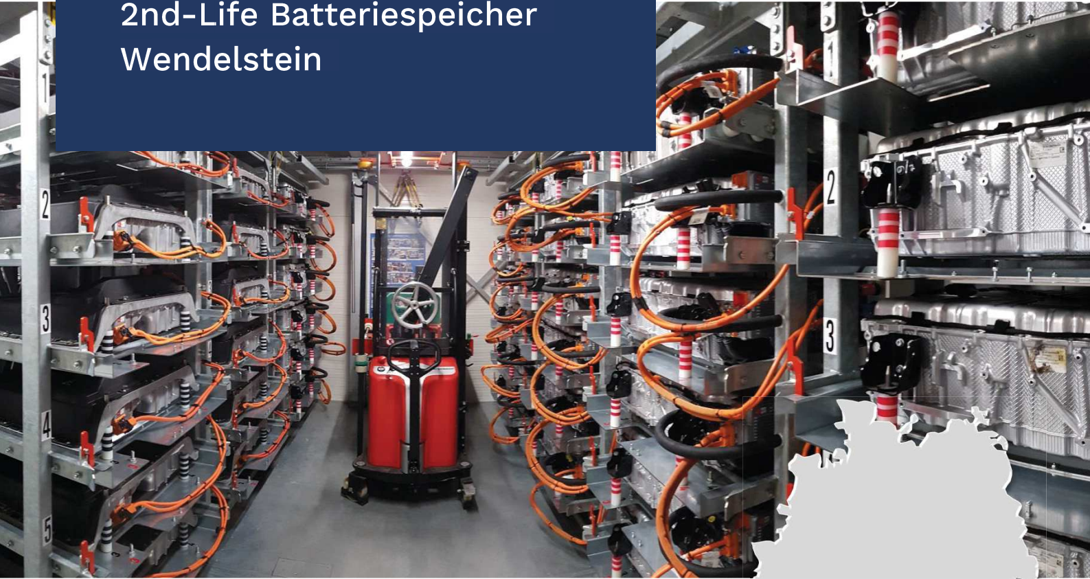
Einblick in den 2nd-Life Batteriespeicher in Wendelstein
